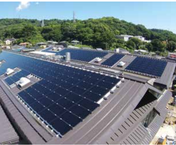
太陽熱コレクターを設置し、組み上げた地下水を温めてレストランで使用
